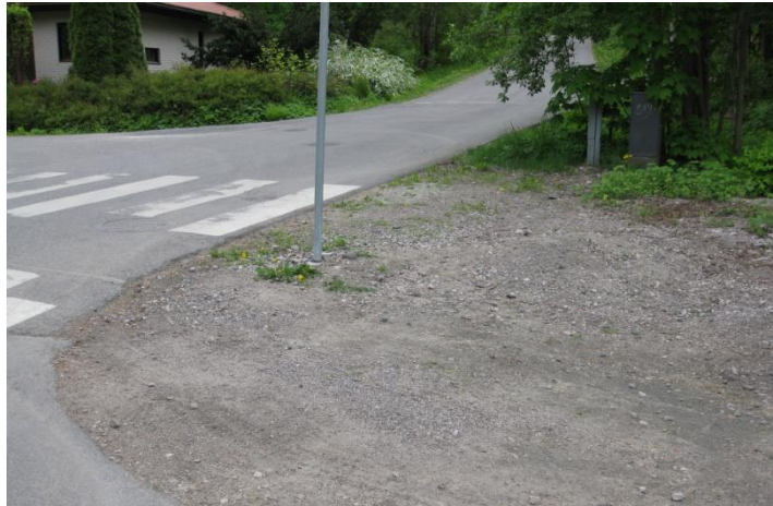
Jollakujan risteys on kulunut ja kasvion. (piirustus 5, merkintä nro. 3).
