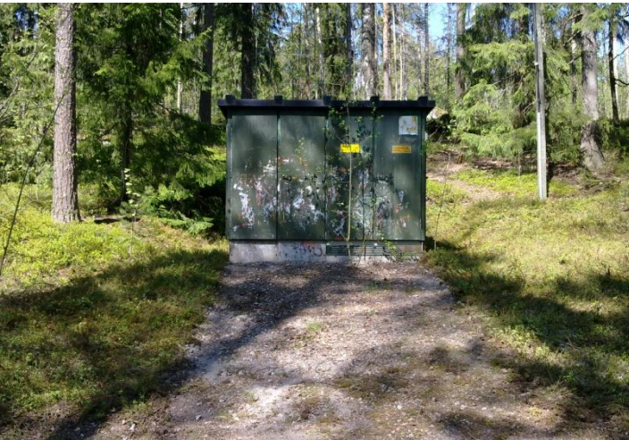
Lindstedtintien sähkömuuntamon ympäristö on maisemoitu kuntalla keväällä 2012, muuntamo kaipasi vielä uutta maalia seiniinsä. (piirustus 4, merkintä nro. 5).
