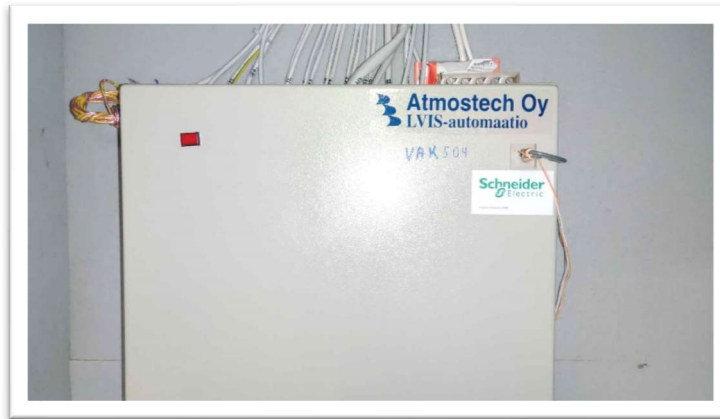
Kuva 4. Valvonta-alakeskus D-osan IV-konehuoneessa.
