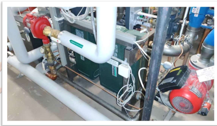
Kuva 3. Kaukolämmön lämmönjakokeskus A-osan lämmönjakohuoneessa
